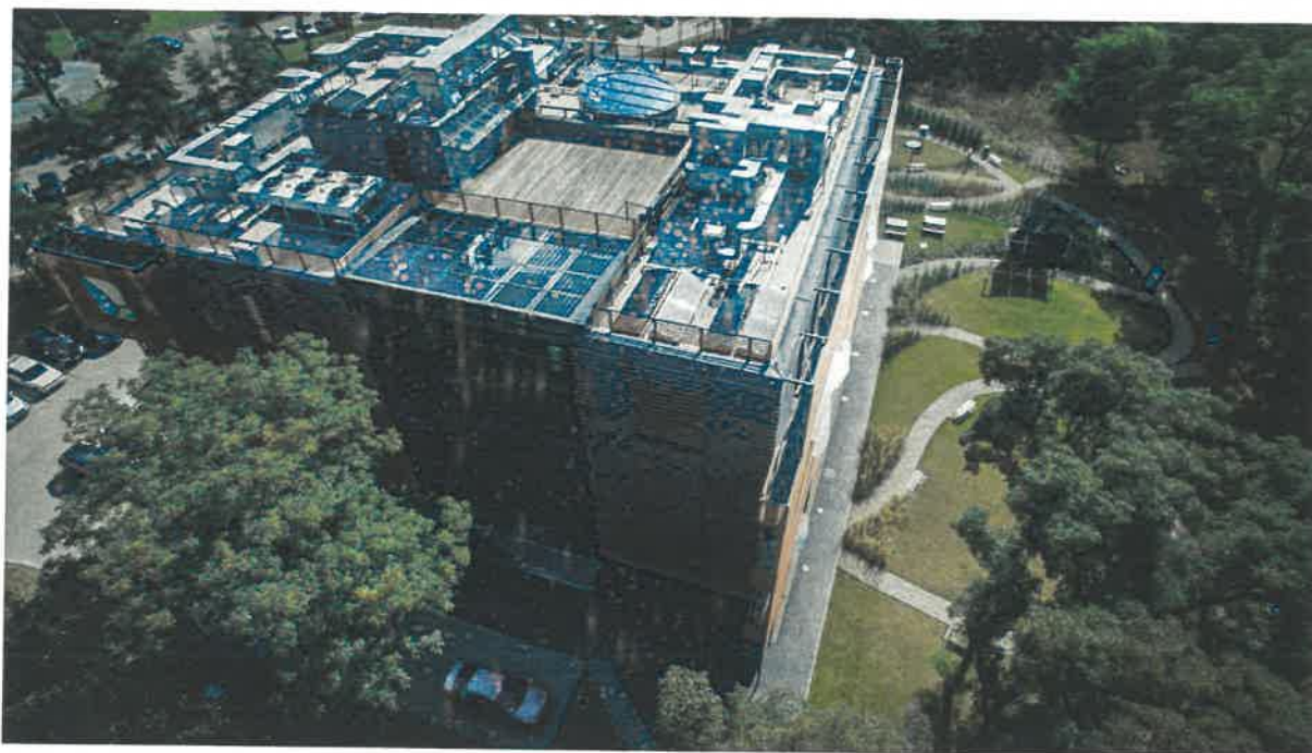
Fot. 2. Instalacje fotowoltaiczne na budynku siedziby WFOŚiGW w Łodzi.
