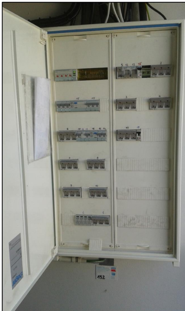
Rys. 1. Rozdzielnia THVAC w nadbudówce na dachu budynku.
